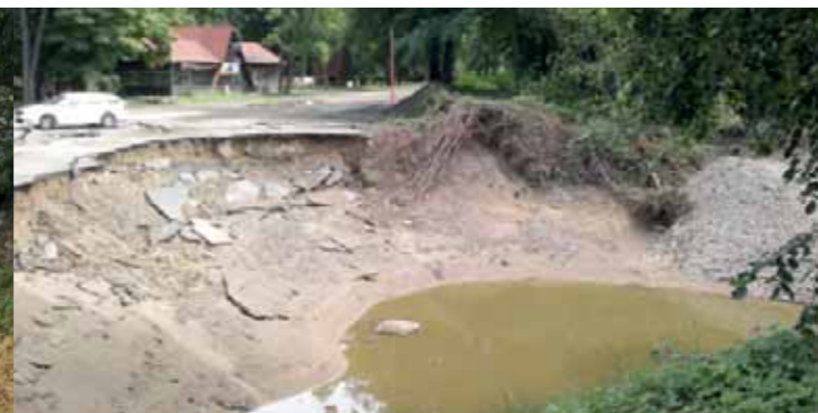
Ochranná hráz ve Veltrusích u Laudonova pavilonu po povodni
