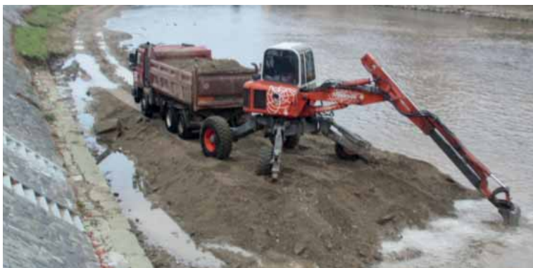
Otava ve Strakonících – odstraňování škod po povodni v červnu 2013
