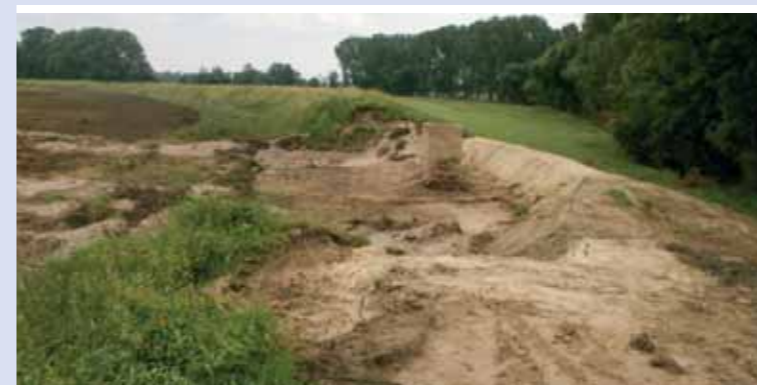
Ochranná hráz Vrbno – Zelčín – stav po povodni
