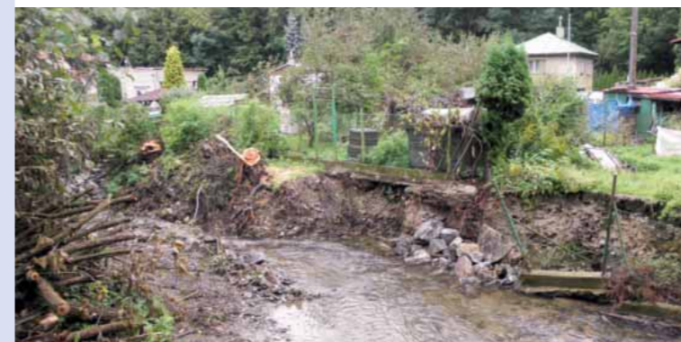
Bojovský potok – stav po povodni
